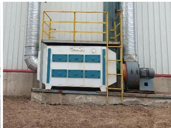
污水处理车间废气措施 (活性炭吸附)
