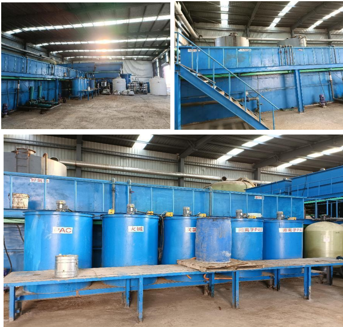
污水处理设施
