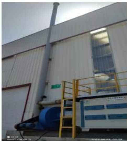
DA001 破乳废气排放口
