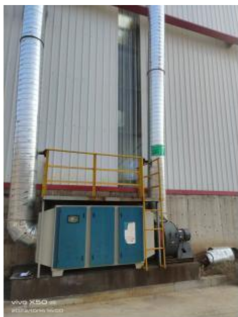
DA007 配伍和焚烧原料库废气排 气筒
