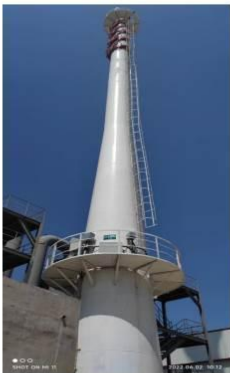
DA004 焚烧废气排气筒
