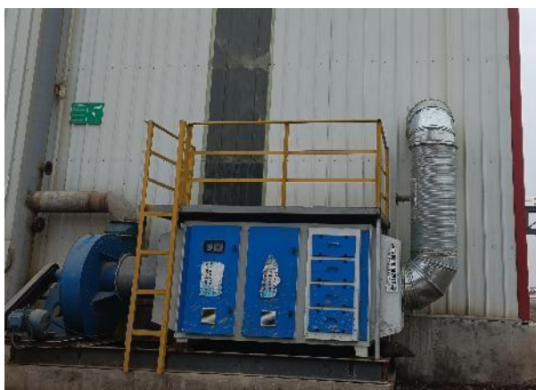
破乳废气措施 (UV 光催化+活性炭吸附)
