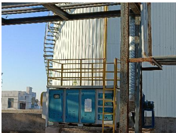
罐区废气措施 (UV 光催化+活性炭吸附)
