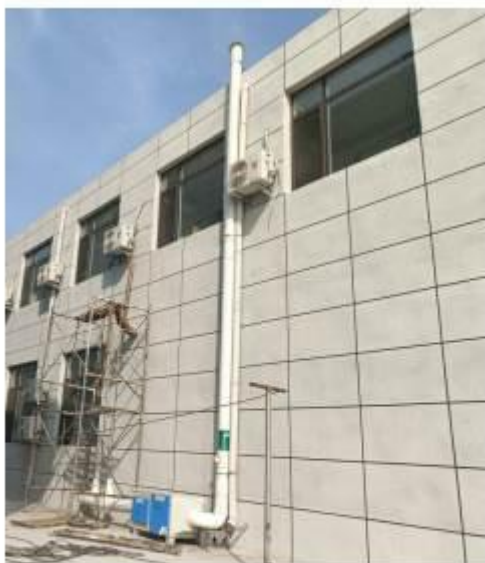
DA003 实验室废气排气筒
