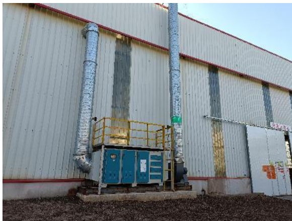
油泥废气措施 (UV 光催化+活性炭吸附)
