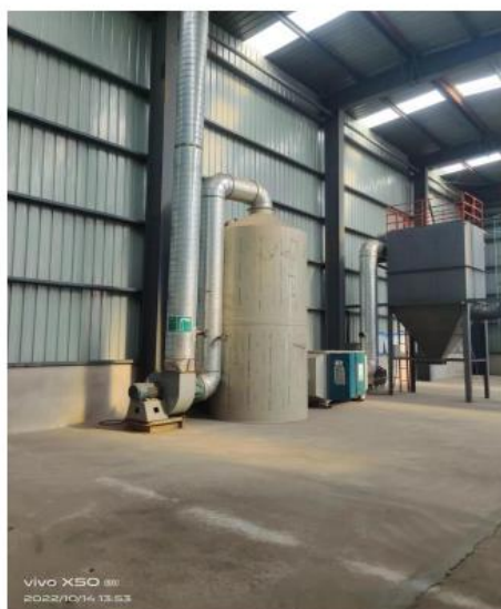
DA008 废催化剂排气筒 (固化)
